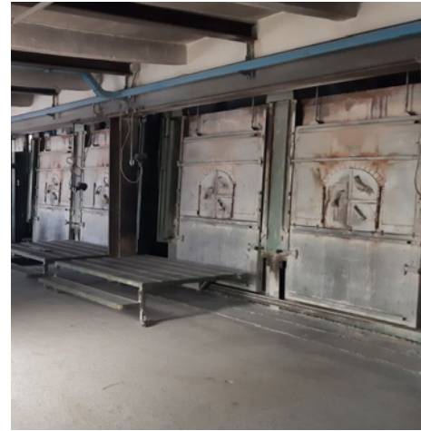
Forni di raffreddamento
